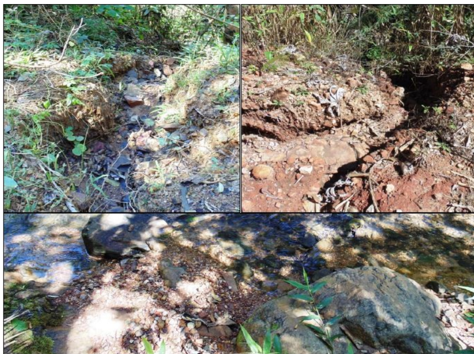
Figura 2: Vista dos locais com erosão no trajeto da estrada compreendido, carreando material diretamente no leito do Córrego Sucuri.
